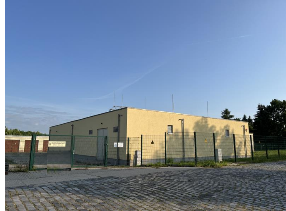
Beispiel Umspannwerk N - Wiederitzscher Weg
