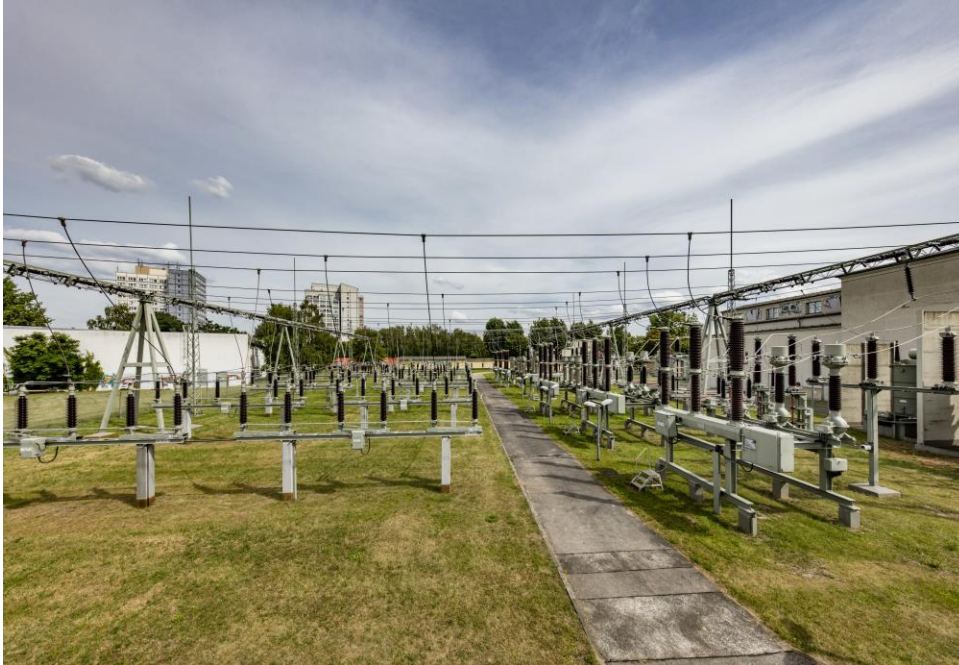
Beispiel Umspannwerk Ost Volksgartstraße
